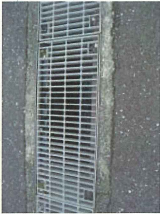
グレーチングの間隔が広く踏きやすい。手押し車など車輪がはまる。
