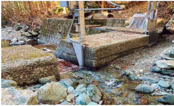
水路取水地に設置した頭首工ゲート(中央)と 取水口ゲート(右端) (吉延)
