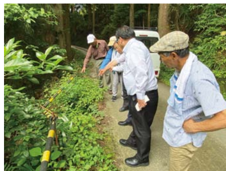
▲崩落している路肩（古田地区）
