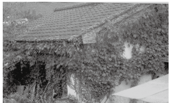
▲老朽化した町有住宅
