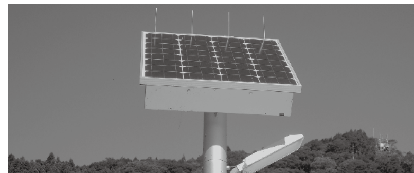
▲太陽光・蓄電方式の外灯
