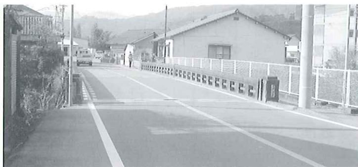
▲早期改修が望まれる国道 439 号井窪付近
