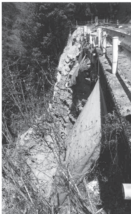
▲県道264号線被災箇所
