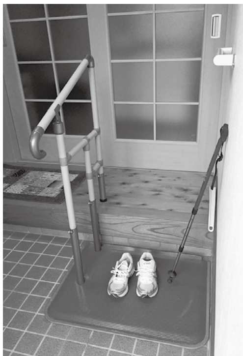
▲玄関に設置された手すり
