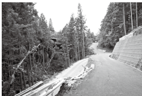
▲北山地区災害現場
