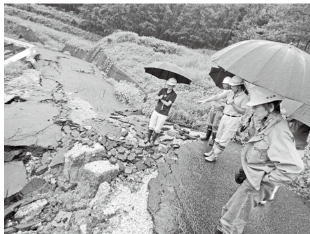
▲高角地区災害現場
