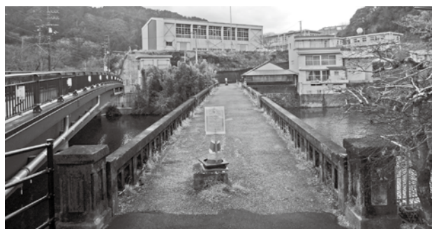
▲撤去が急がれる旧吉野橋
