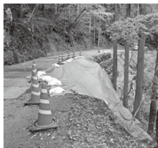
▲町道上関線梅ノ (バイノ) 崩落現場
