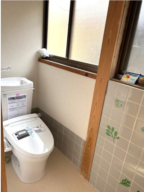
簡易水洗トイレ
