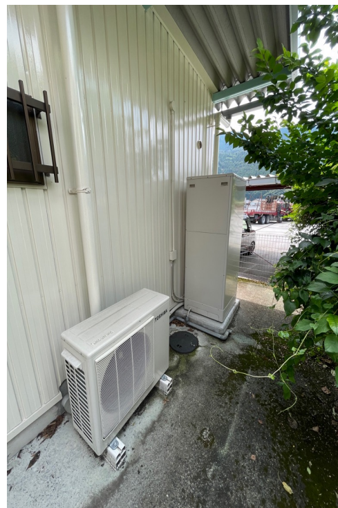
エコキュート設備
